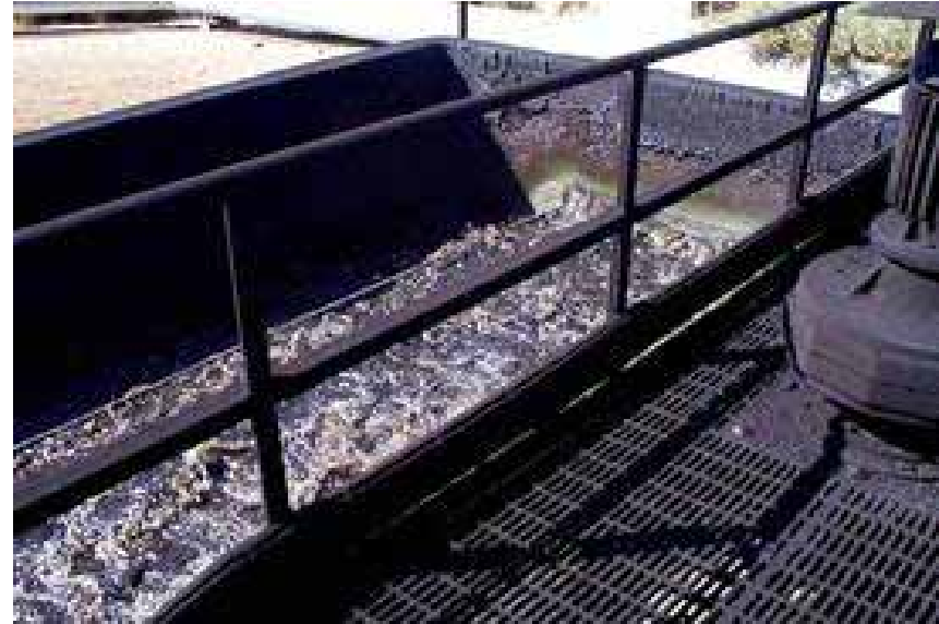
Floculateur (récupération HC et MES)
